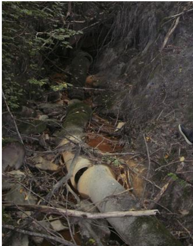
Bilde 2: I enden av rørgata spyles leira vekk i lekkasjer mellom de siste rørene, og det siste røret dras ut. Dette kan gjenta seg videre innover. (Foto: Atle Hauge)
