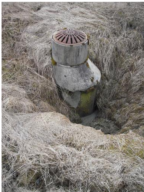
Bilde 1: Kummer med lekkasjer blir stående som piper i et erosjonskrater som kan gå helt ned til bunnledningen. Foto: Atle Hauge
